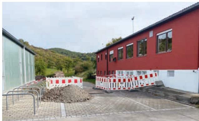
Bereits in der Woche nach dem Mitgliederbeschluss begannen die ersten Bauarbeiten am TSV-Sportheim.
