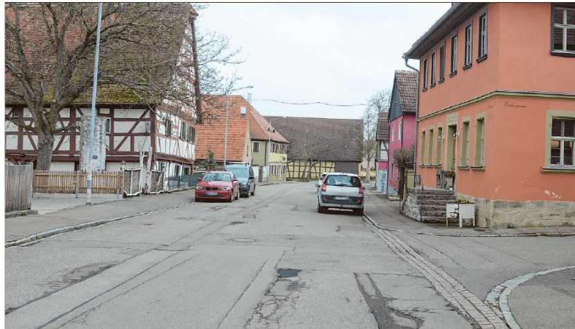
In der Rodgasse gibt es dringenden Sanierungsbedarf. Foto: Günter Blank
