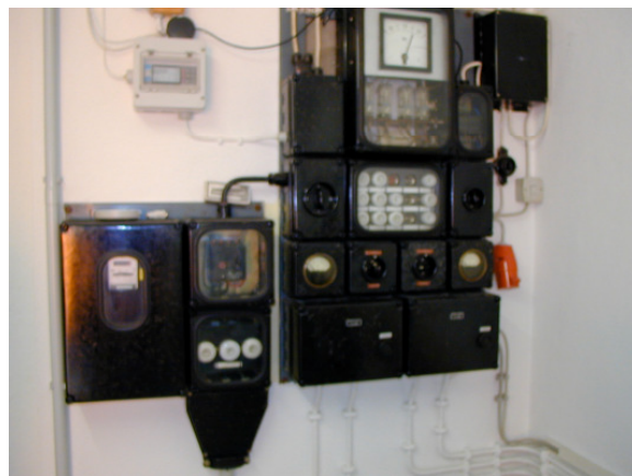
Elektro- und Fernwirkanlage aus den 50er Jahren
